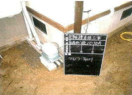
【写真9】ブロワ設置状況を示す写真
