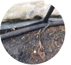
劣化し亀裂が発生した配管
