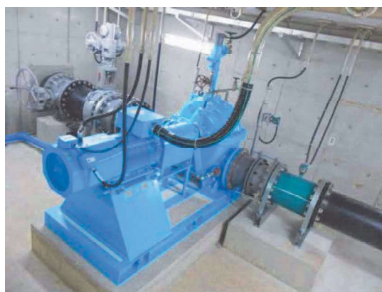
小水力発電（戸島送水場）
