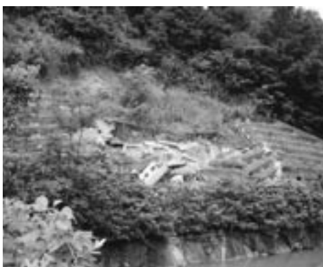
7月6日の豪雨により崩壊した観音山グラウンドの擁壁
