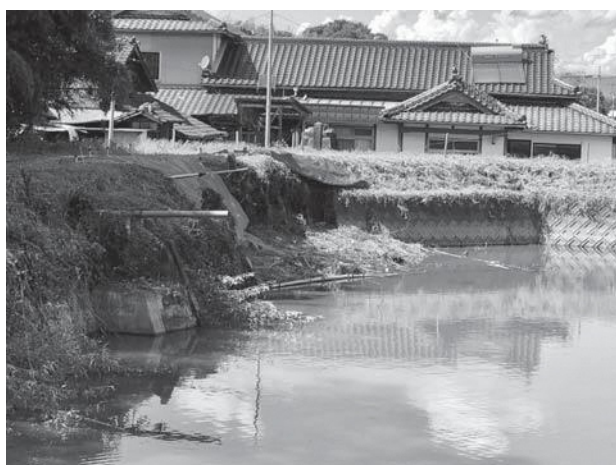
民家のすぐ横で崩落した島堤ため池
