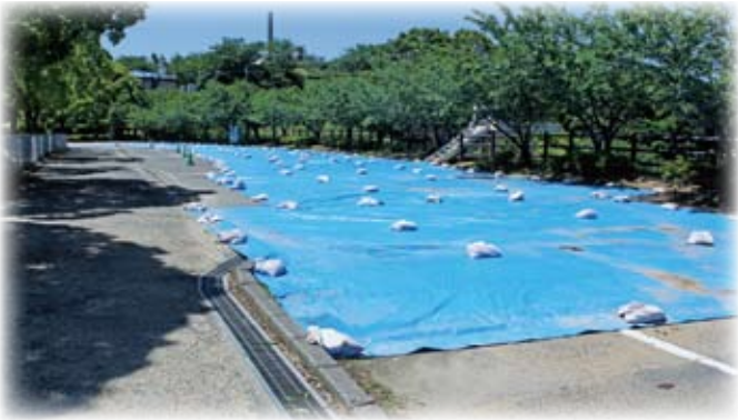
駐車場に亀裂が入りブルーシートで覆われている岡岳総合運動公園
