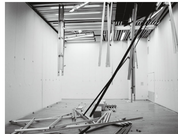
天井材が落下している展示室の様子
