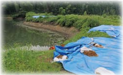
堤体の亀裂にブルーシートが覆われているため池＝豊野町
