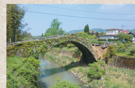
▲震災で被災した下鶴橋(豊野町)
