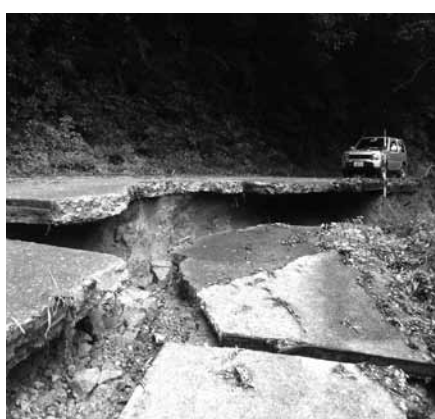
豪雨により崩壊した内田地区林道
