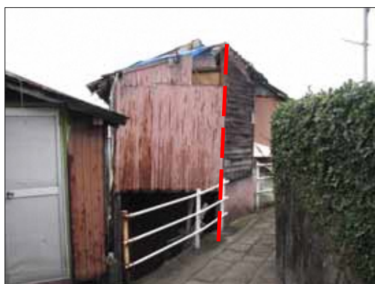
一部の柱が傾斜している例
