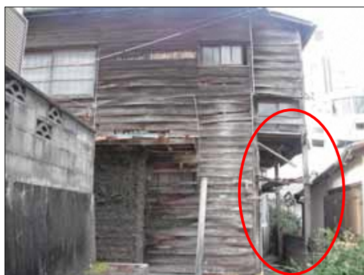
柱の数箇所に破損がある例
