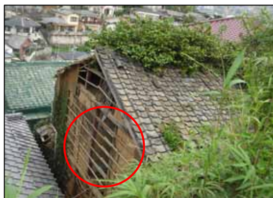
外壁が剥落し、著しく下地が露 出するとともに、壁体を貫通する 穴を生じている例
