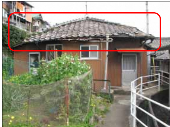
屋根に不陸がある例
