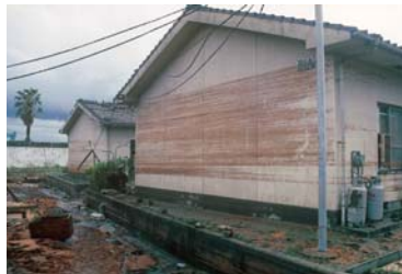
屋根下まで水位が上がり、4人が亡くなった町営松合住宅
