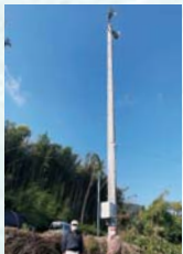
不知火町長崎区に整備した防災無線
