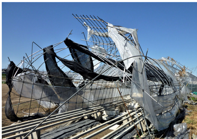
台風被害の様子
