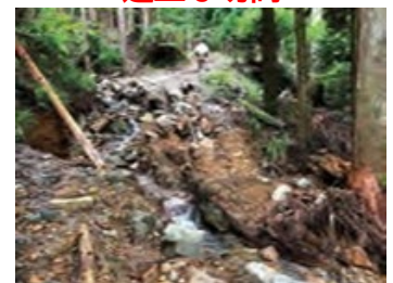
谷に盛土した作業道の崩壊
