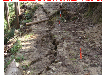
盛土で発生したクラック
