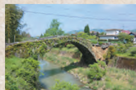
▲震災で被災した下鶴橋(豊野町)
