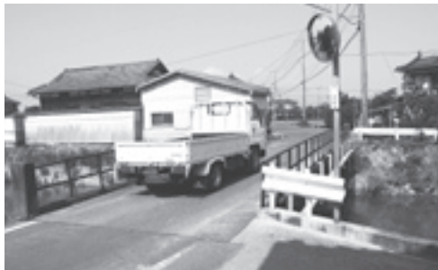
架替え、歩道設置が望まれる出村橋
