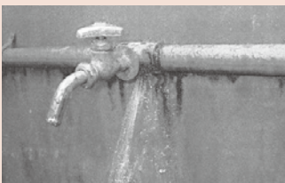
屋外水道管の破裂
