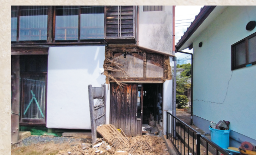
▲ 松合郷土資料館(不知火町)の被害
