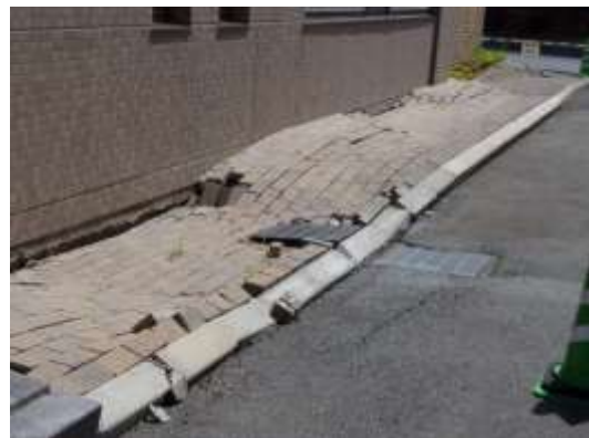
▲H28 熊本地震により被災した新館の様子
