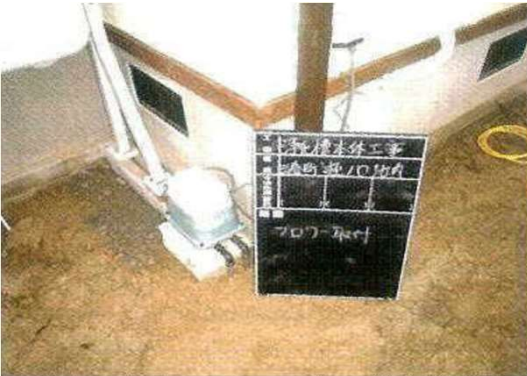
【写真9】 ブロワ設置状況を示す写真
