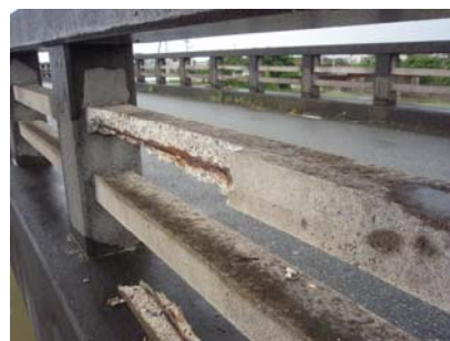
写真-7. 高欄の損傷
