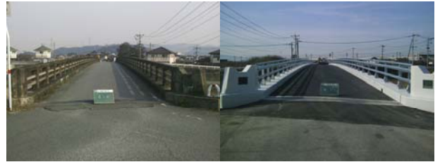
写真-2. 大野川を渡河する永代橋 橋長 70.8m PCポステンT桁橋 昭和 61 年築造 供用年数 28 年
