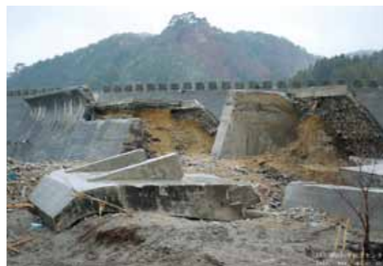
津波で破壊された防潮堤(岩手県宮古市) (財団法人 消防科学総合センター提供)
