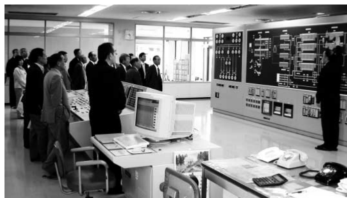
汚水を処理してきれいな水に変え、自然に還します（松橋・不知火浄水管理センター）
